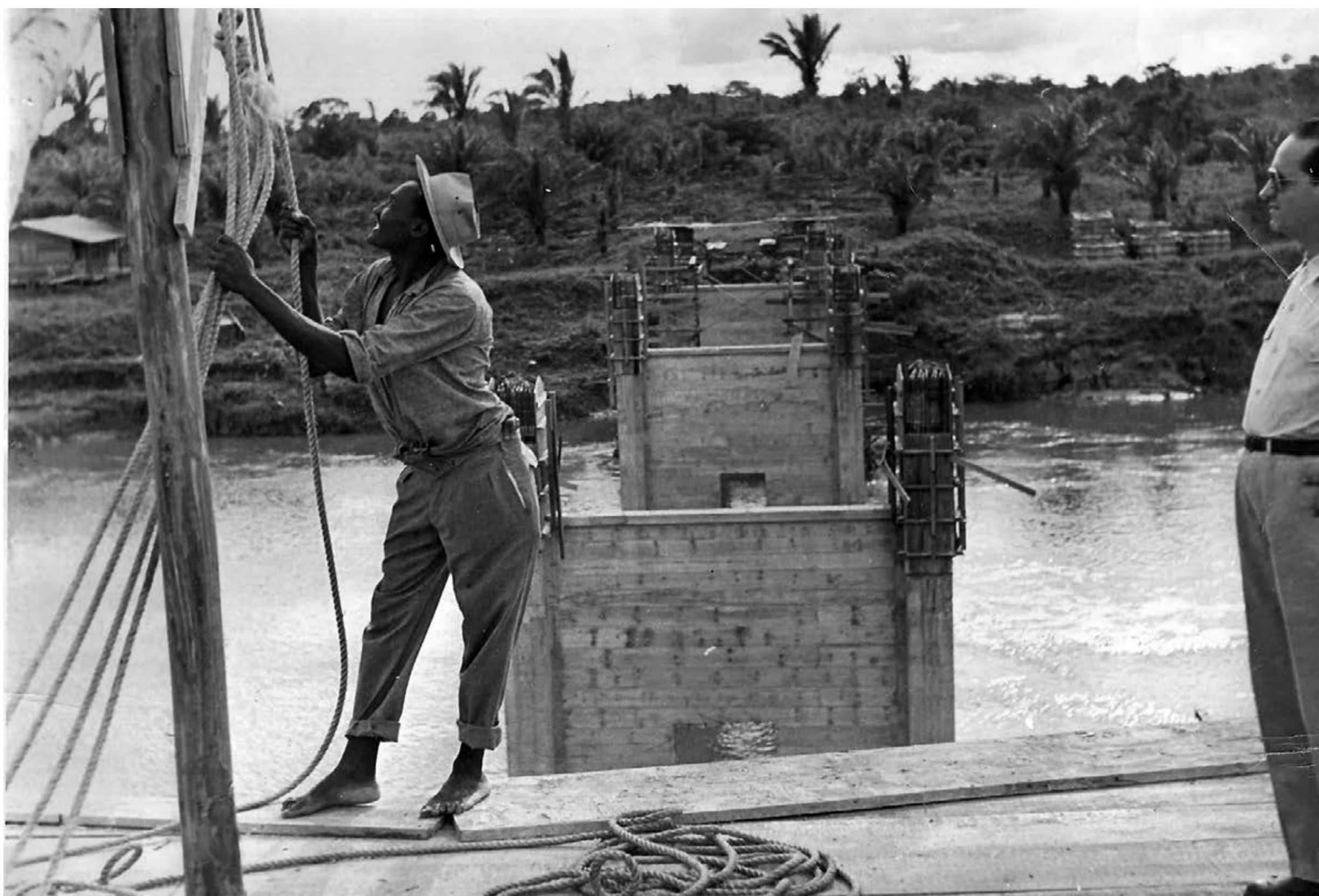
OBRAS DA PONTE: Operário sobre um dos pilares da ponte em construção no rio Garças, 1955
