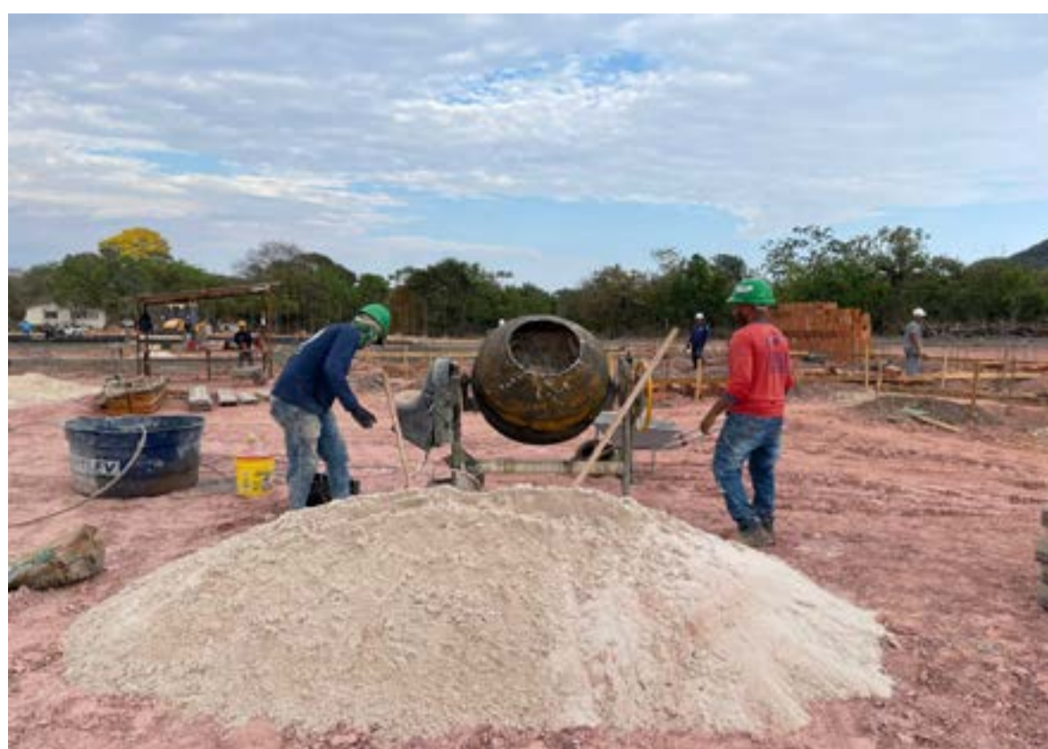
OBRA: Profissionais da construção civil em atividade no início dos trabalhos de fundação
